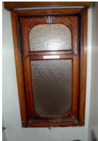
Fönster på toalett innan restaurering.
