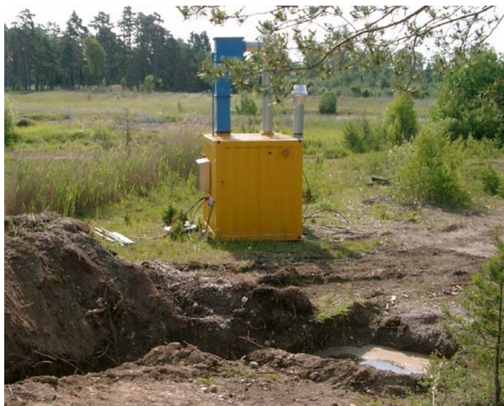
Figur 6. Mobil reningsanläggning för vatten, placerad i Träkumla på Gotland.
